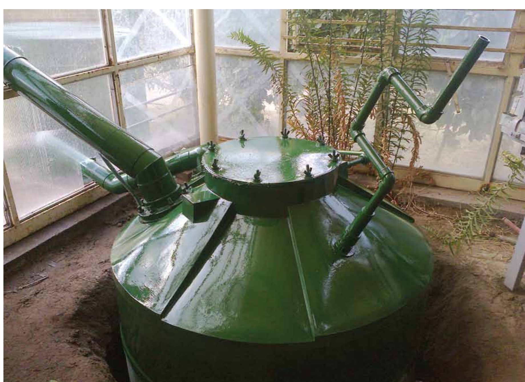
Biodigestor instalado en escuela técnico-agraria.
